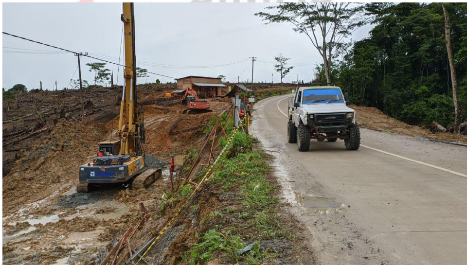
Lampiran 3 Kondisi Bahu Jalan STA 0+30 sampai STA 0+90
