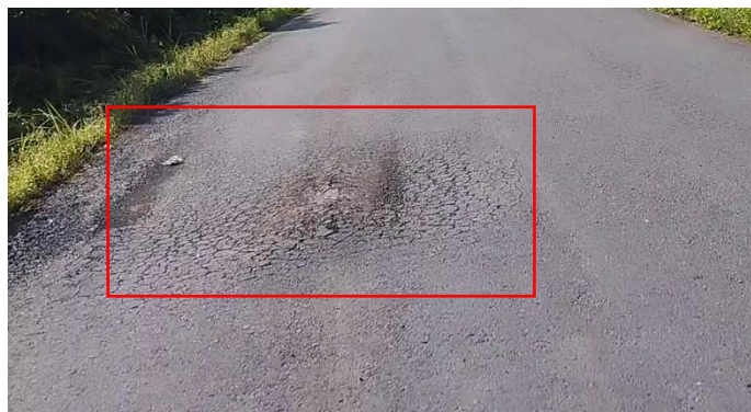
Gambar 2. 2 Retak Kulit Buaya (Dokumen Pribadi)
