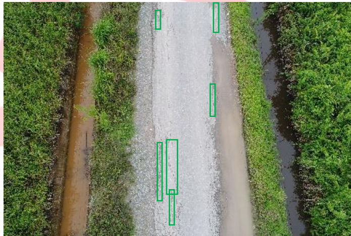
Gambar 2. 11 Longitudinal Crack (Dokumen Pribadi)
