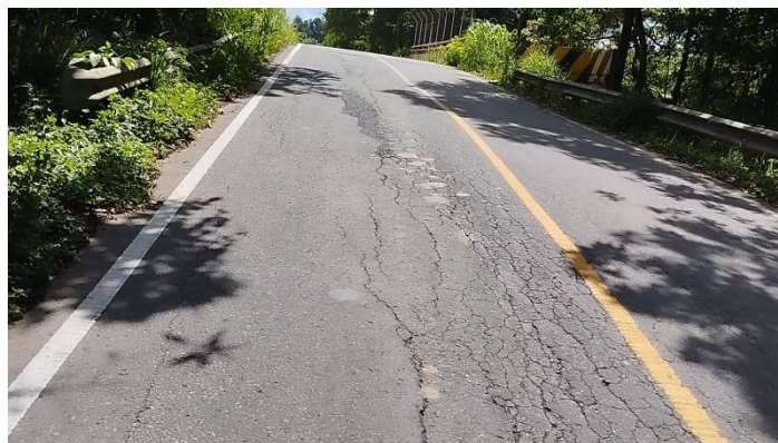
Gambar 2. 4 Retak Memanjang (Dokumen Pribadi)
