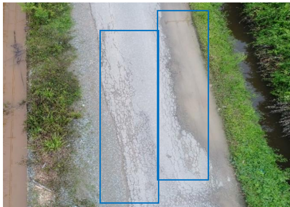
Gambar 2. 9 Structural Crack (Dokumen Pribadi)
