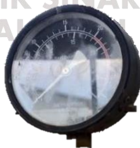
Gambar 2.3 Pressure Gauge Sumber : Dokumentasi Pribadi (2022)
