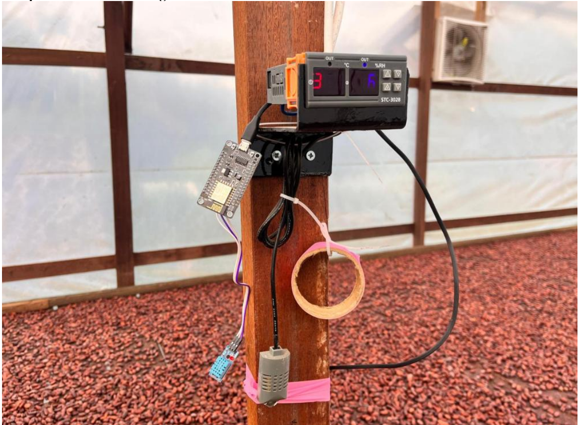
Lampiran 9 Instalasi Perangkat Keras
