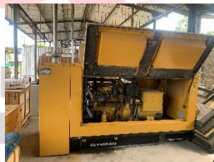
Gambar 2.1 Genset GP110-2 Sumber : Dokumentasi pribadi (2024)
