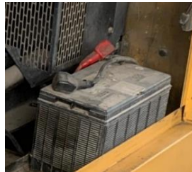
Gambar 2.8 Battery Sumber : Dokumentasi pribadi (2024)
