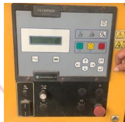
Gambar 2.9 Control Panel Sumber : Dokumentasi pribadi (2024)
