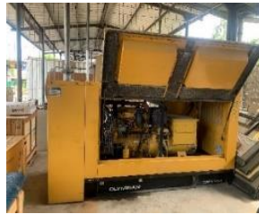
Gambar 3.3 Genset GP110-2 Sumber : Dokumentasi pribadi (2024)
