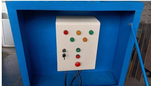
Gambar 2. 3 Panel box (Sumber. Dokumentasi pribadi)
