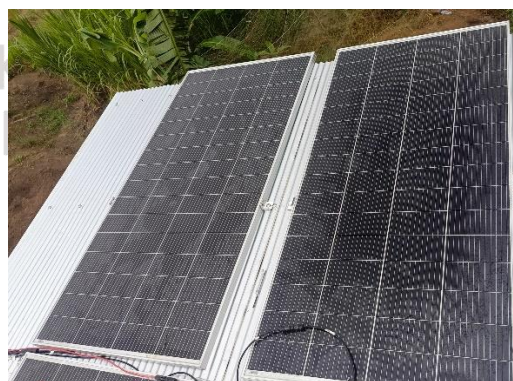
Gambar 3.6 Panel Surya Jenis Monocrystalline (Sumber : Dokumentasi Pribadi)
