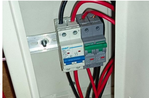
Gambar 3.7 Miniature Circuit Breaker (MCB) (Sumber : Dokumentasi Pribadi)
