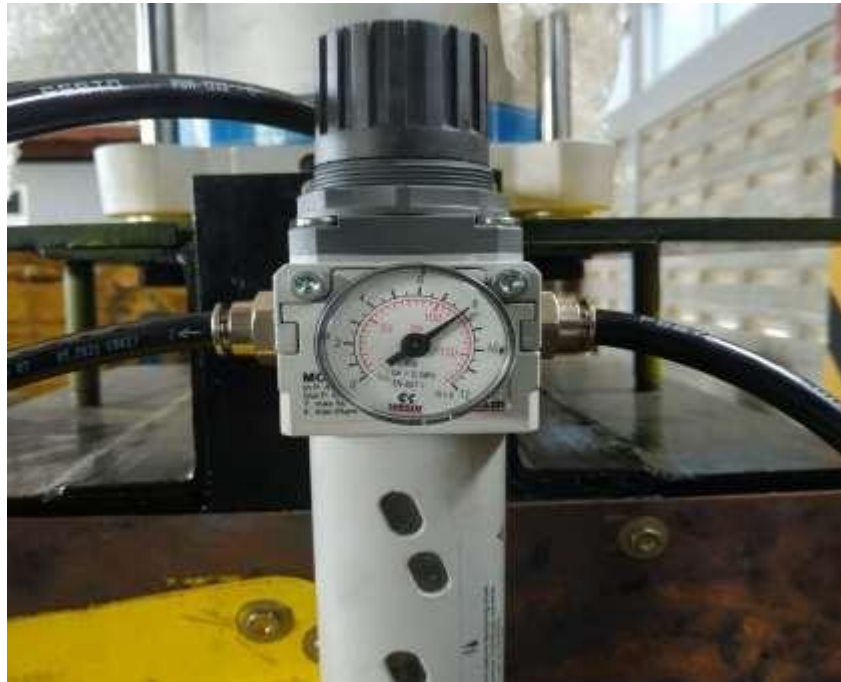
Gambar 3. 19 Tekanan pada regulator sebesar 8 bar (Dokumentasi pribadi, 2022)
