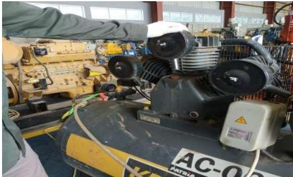
Lampiran 1. 3 Pengecekan kompresor
