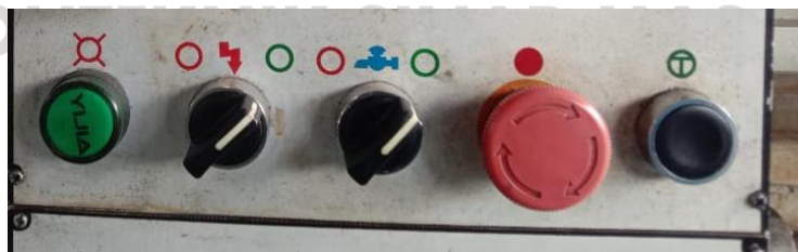
Gambar 2.15 Control Panel / Panel Kendali Sumber : Dokumentasi Pribadi (2022)
