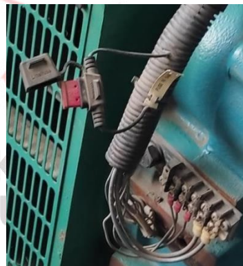
Gambar 2.10 Sekring Sumber: Dokumentasi Pribadi 2023
