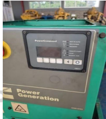
Gambar 2.9 Panel Kontrol Genset Sumber: Dokumentasi Pribadi 2023
