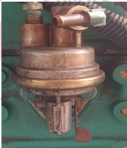
Gambar 2. 2 Feed Pump Sumber: Dokumentasi Pribadi
