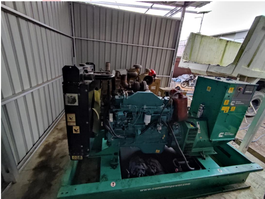
Gambar 6 Dokumentasi Generator Set Right
