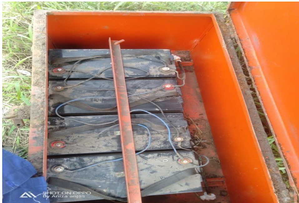
Gambar 2.5 battery Sumber : dokumentasi pribadi 2023
