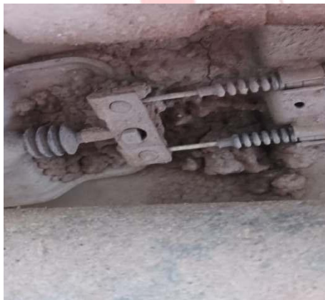
Gambar 21 kondisi kabel kotor
