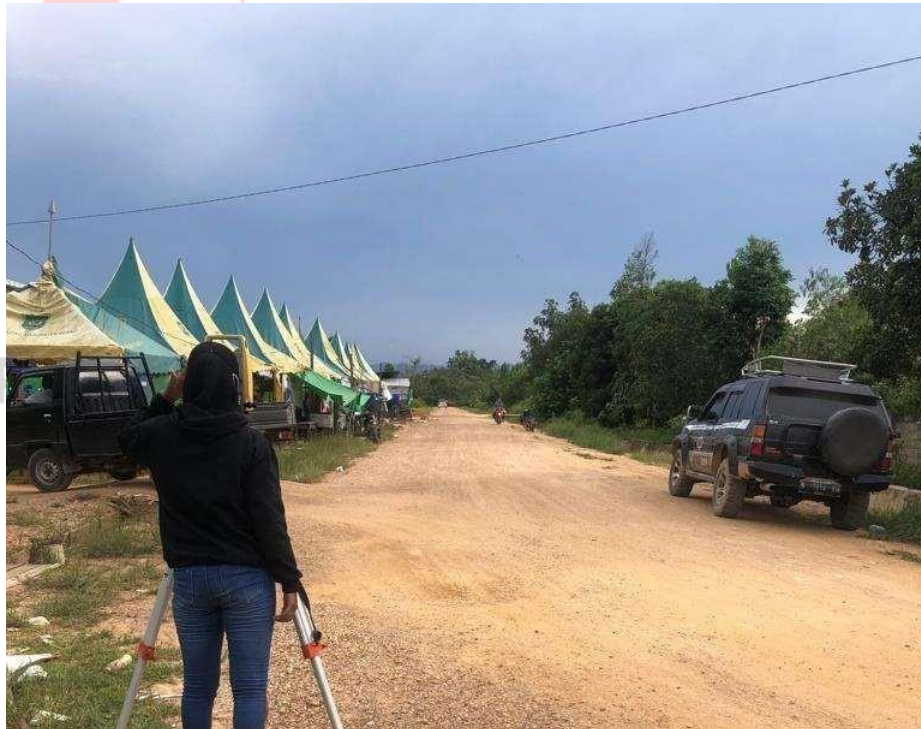
Gambar 1. 2 Kondisi Jalan Pandu dari STA 0+075 hingga STA 0+778
